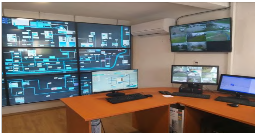
Slika broj 10: Telemetrijski sistem za nadzor i upravljanje
