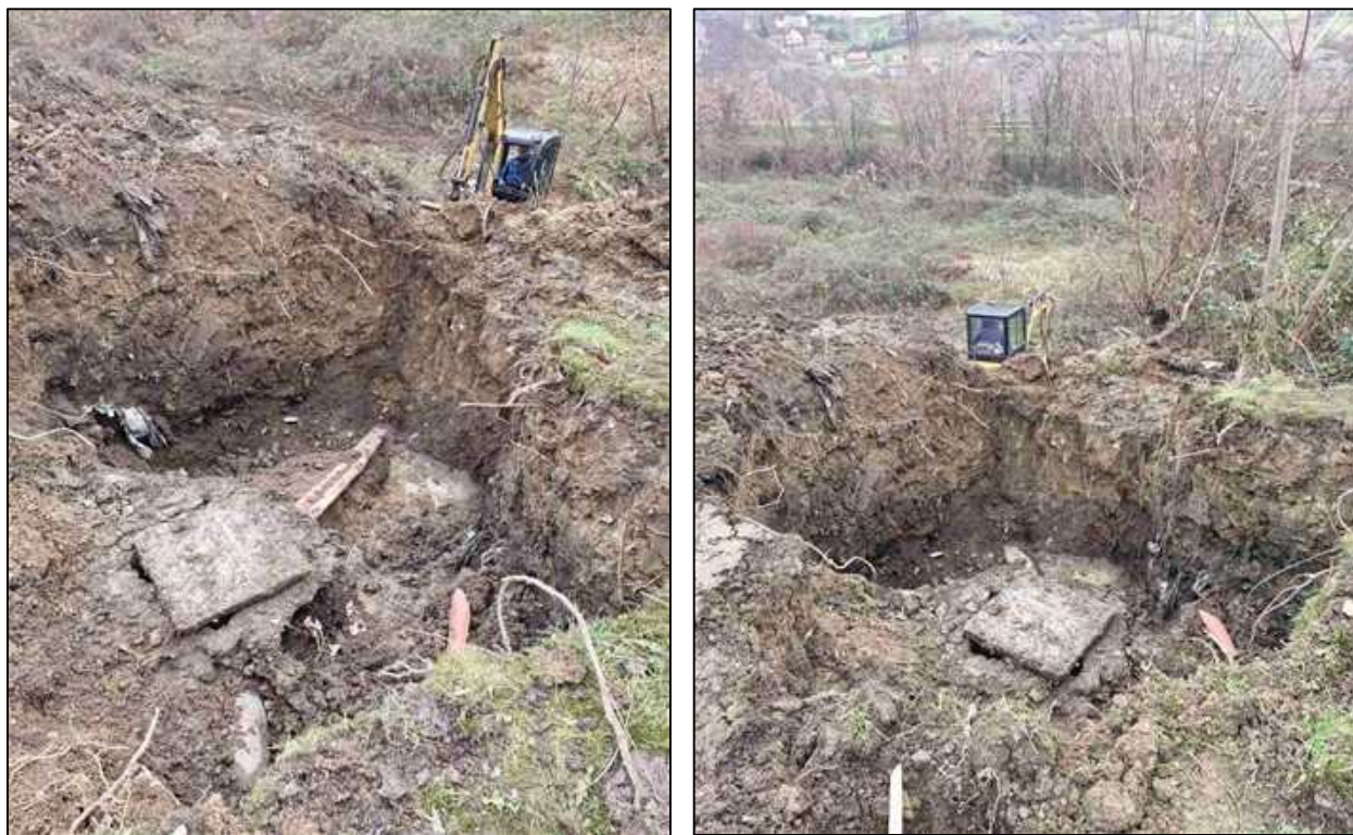
Slike broj 12 i 13: Mjesto kvara na kanalizacionoj liniji u ulici Tetovska
